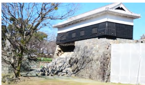
(熊本地震で崩れた石垣)
